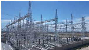
变电站 Electrical Substation
