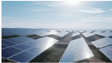
新能源 New Energy
