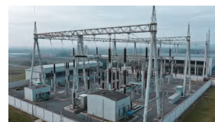
变电站 Electrical Substation
