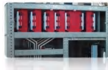
柜顶母线 Busbar on top
