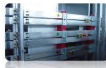
柜后母线 Busbar on rear
