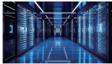
数据中心 Data Center
