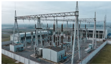
变电站 Electrical Substation
