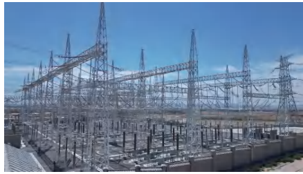
变电站 Electrical Substation
